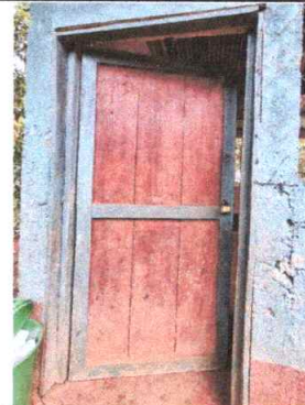
Foto 2: En la imagen se logra apreciar el estado en que se encuentra la puerta del establecimiento
